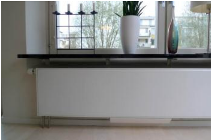
Radiatorn är kombinerad med uteluftsintaget, som kan skymtas under radiatoren.
