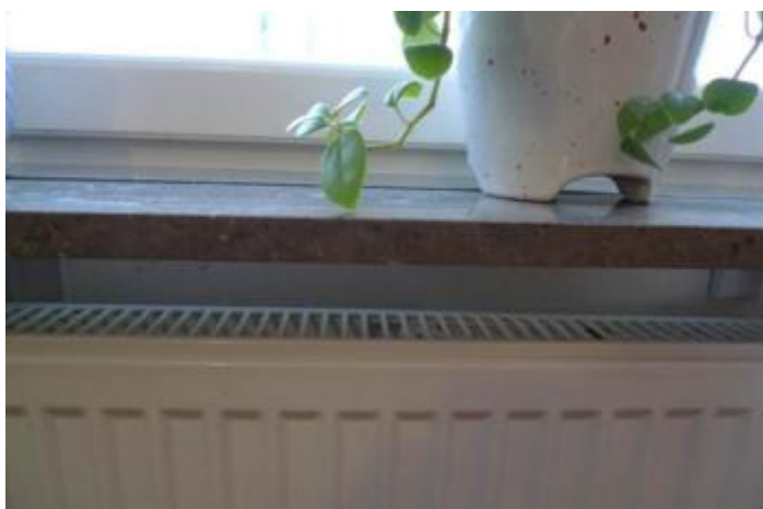
Radiatorerna med uteluftsdon bakom är fällbara, vilket krävs för filterbyte och underlättar städning.
