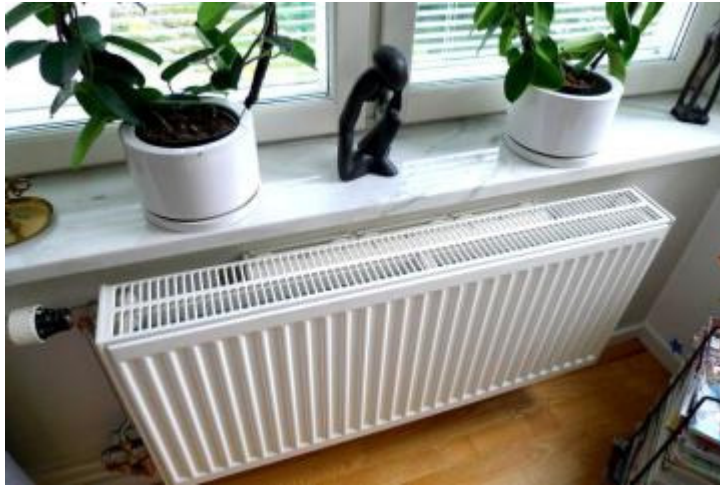
Radiatorn med ett integrerat uteluftsdon bakom.
